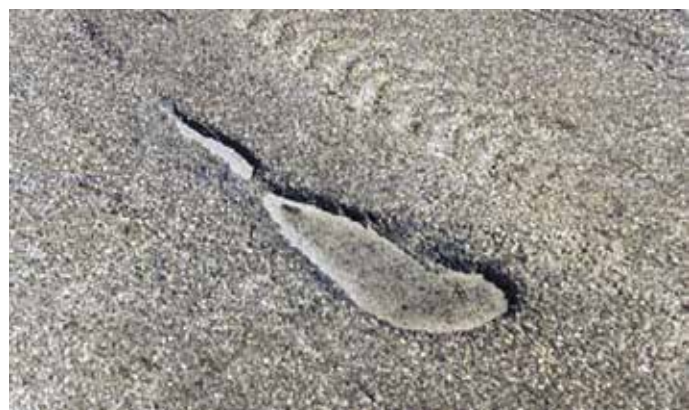
1. Esempio di rottura sulla pavimentazione per effetto del distacco tra gli strati
